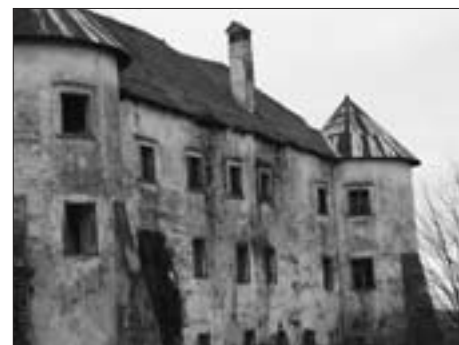
ZATEČENO STANJE DVORCA BELA II., 2003.
